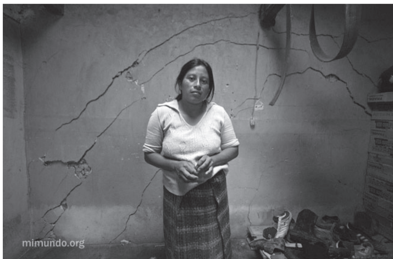
Risse im Beton: Minenbau internationaler Konzerne zerstört die Häuser der Menschen in Guatemala
